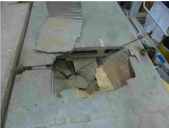
Korkeusvakaajassa oleva paha vaurio
